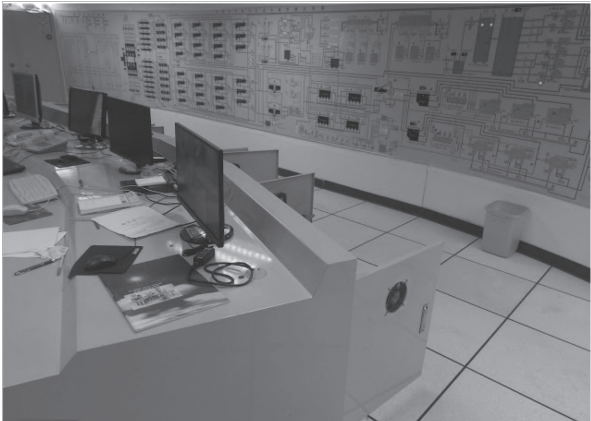
某污水處理站中控中心（3S MARKET 資料照片）
