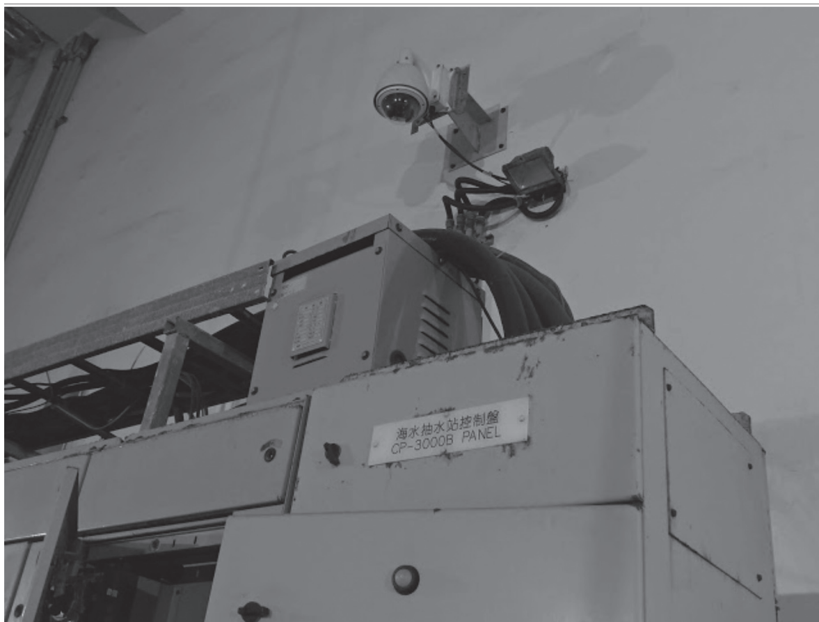
某污水處理站地下抽水站（3S MARKET 資料照片）
